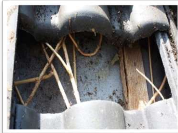
Schaden durch in Dach eingedrungenes Efeu
