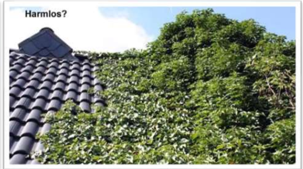
Schaden durch Dach überwachsenes und wahrscheinlich auch eingedrungenes Efeu
