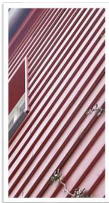
Efeu unterwächst Holzfassade
