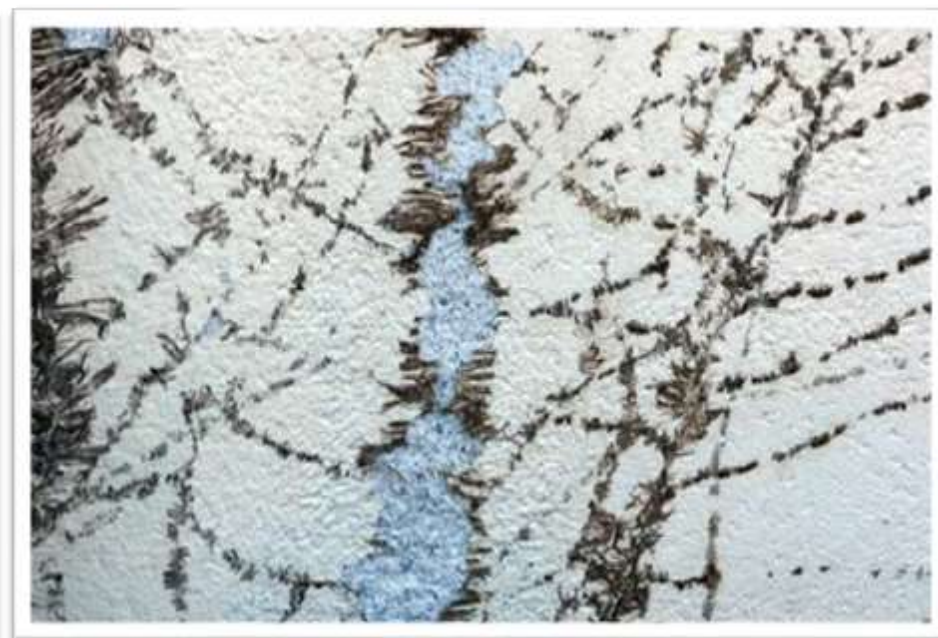
Efeu nicht richtig gepflegt, daher zu schwer geworden. Putz mit Efeu abgefallen. Reste von Haftwurzeln.
