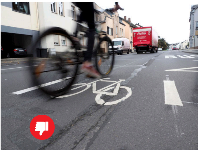
Deutlich erkennbare Fräsrillen im Schutzstreifen
